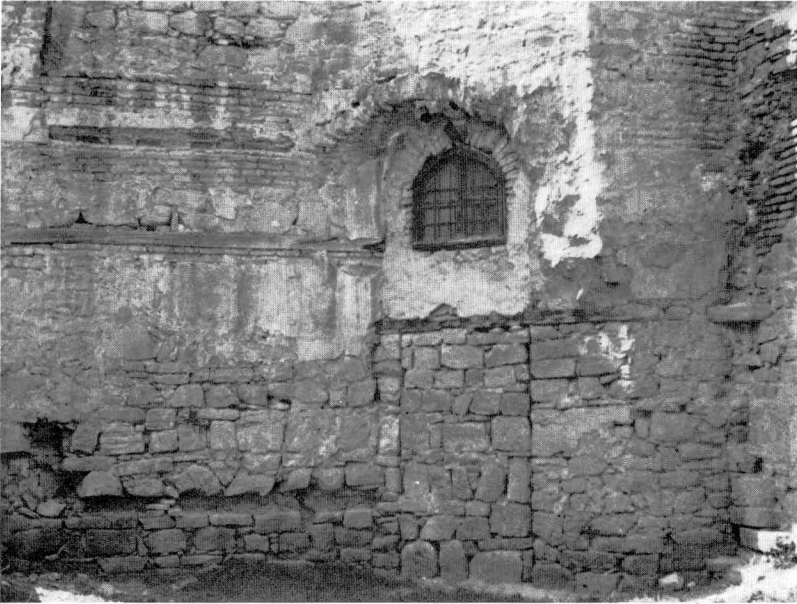
Resim 6. Güney doğu köşe odasına açılan kapının dış yüzünde tonoz kalıntıları.
