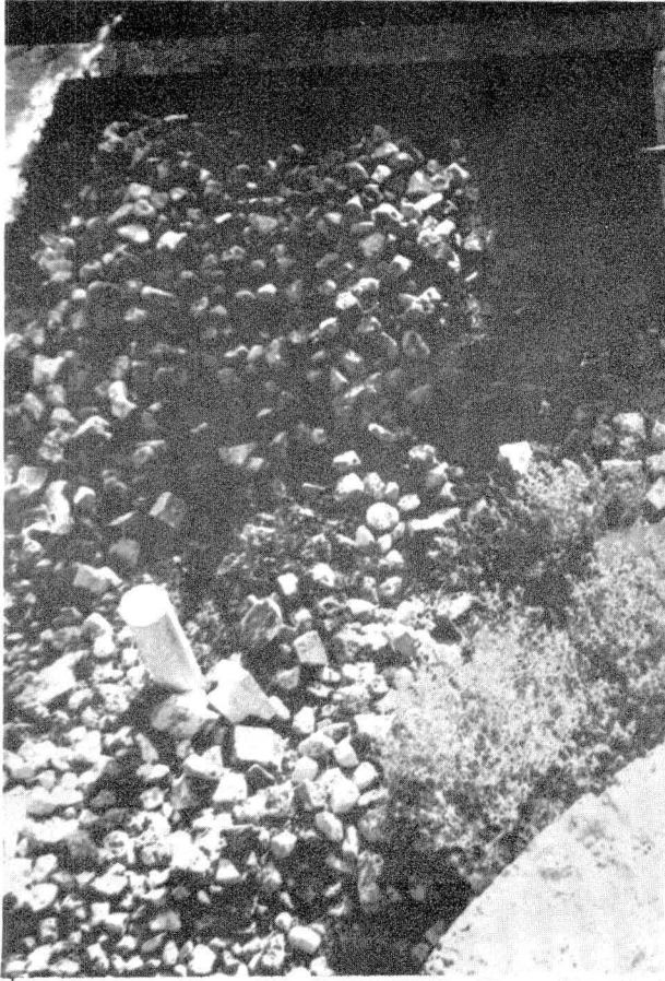
Resim : 15 — Maras Haznedarlı Camisi Harap durumundaki ibadet yerinin minareden görüşü,
